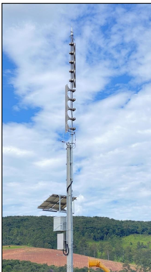
Figura 11.1 – Sirene implantada próximo a ZAS da mancha de inundação da Barragem B1
